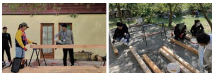
作業③新しい薪小屋になる木材のやすり掛け・下地塗り
